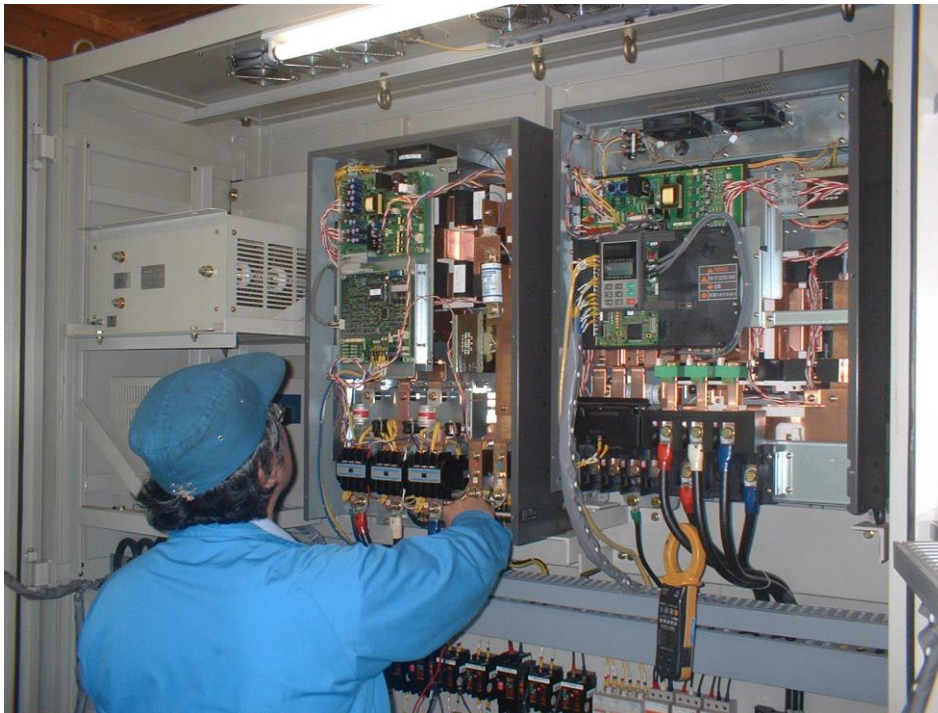
<リフト電気設備 点検、保守>
